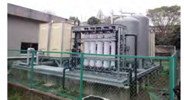
地下水浄化システム
