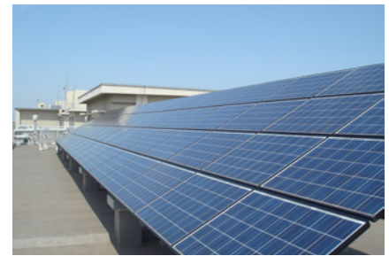
太陽光パネル
