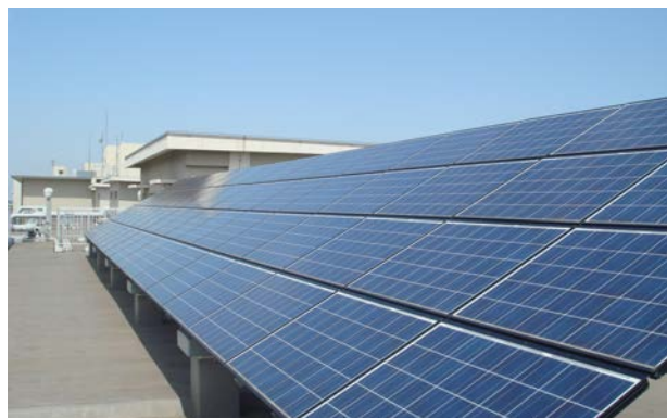
太陽光パネル▶
