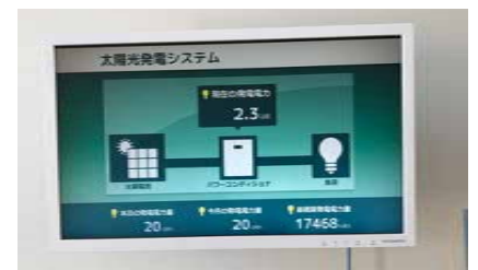
リアルタイムで発電量を表示するモニター
