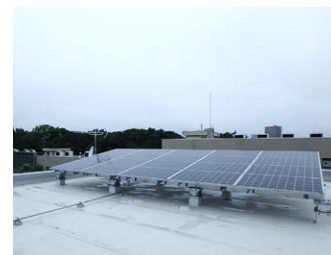
太陽光パネル
