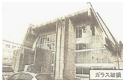
図1-6-1-1 ガラスが破損落下した医学部記念講堂（「23.4.28経営協議会資料」）
