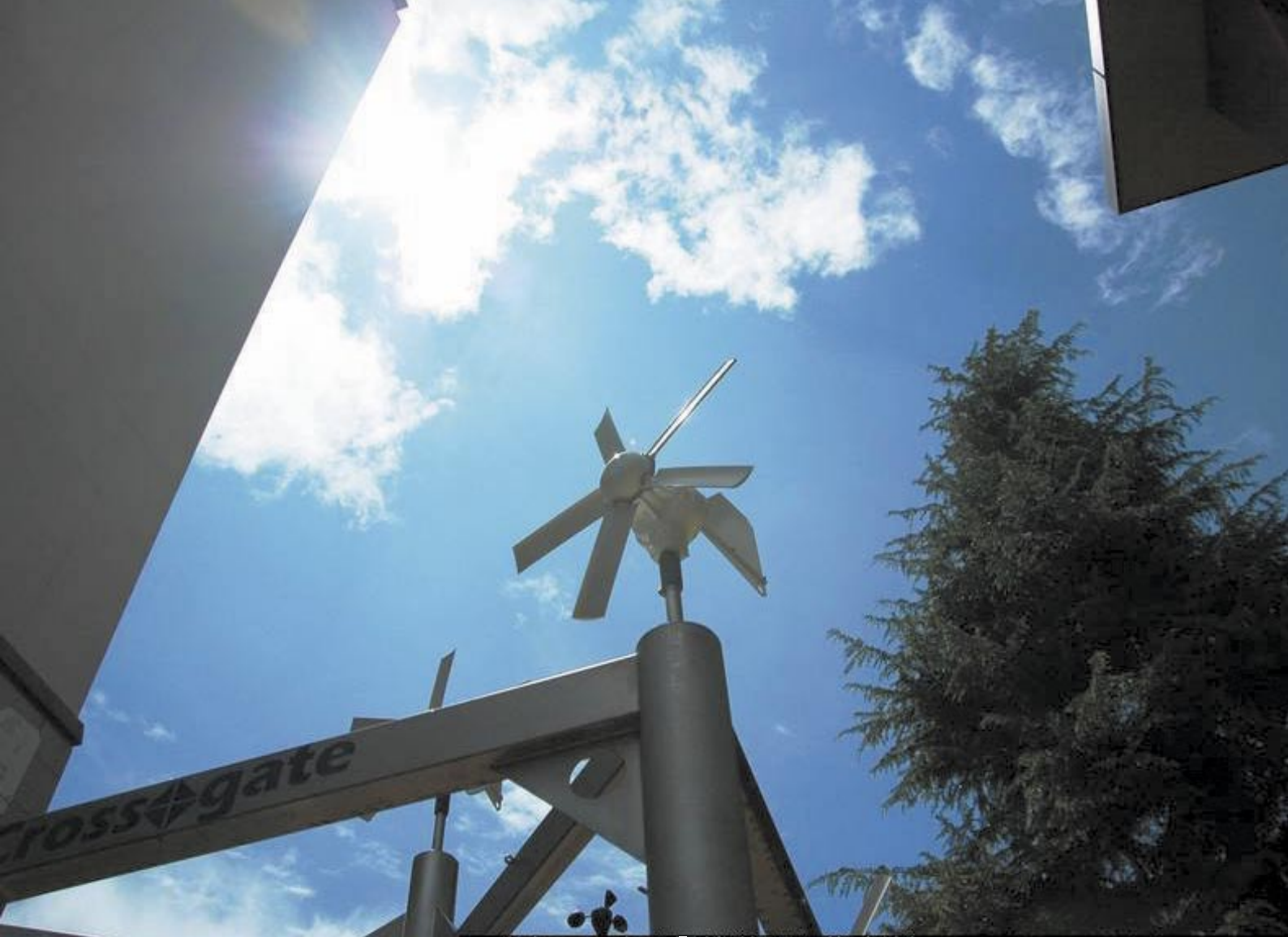
写真 西千葉キャンパスの工学部 15 号棟付近にある風力発電機 撮影者：蒋晓峰
